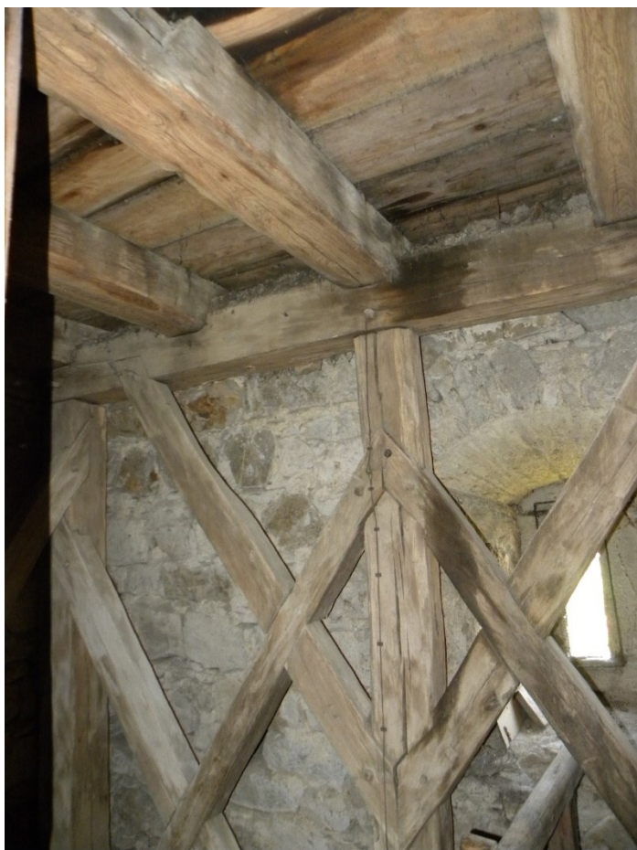
23. Praskolesy kostel sv. Mikuláše – prostor věže, pozůstatky konstrukce podsebití
