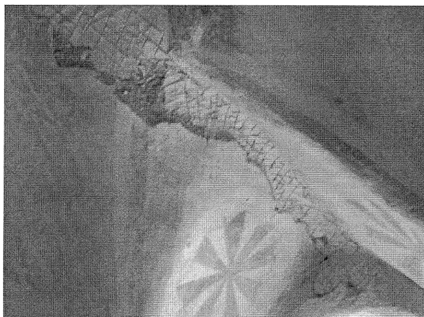
19. Rákoš, kostel Nejsvětější Trojice, trhlina na jižním okně apsidy.
