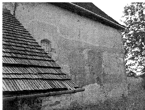
57. Rákoš, kostel Nejsvětější Trojice, polovina 13. století, pohled na severní stěnu od východu.
