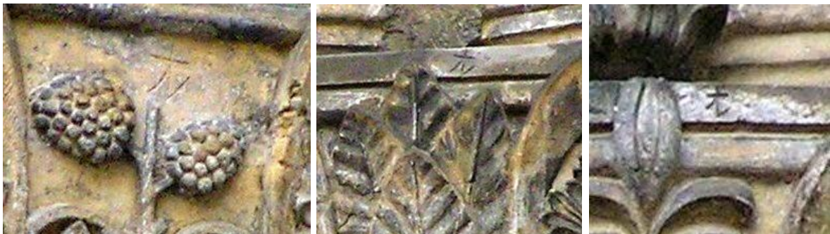
[68] Okna severního průčelí Vladislavského sálu, kolem 1493, pískovec, Pražský hrad, Praha, detail kamenických značek na hlavicích pilastrů.
