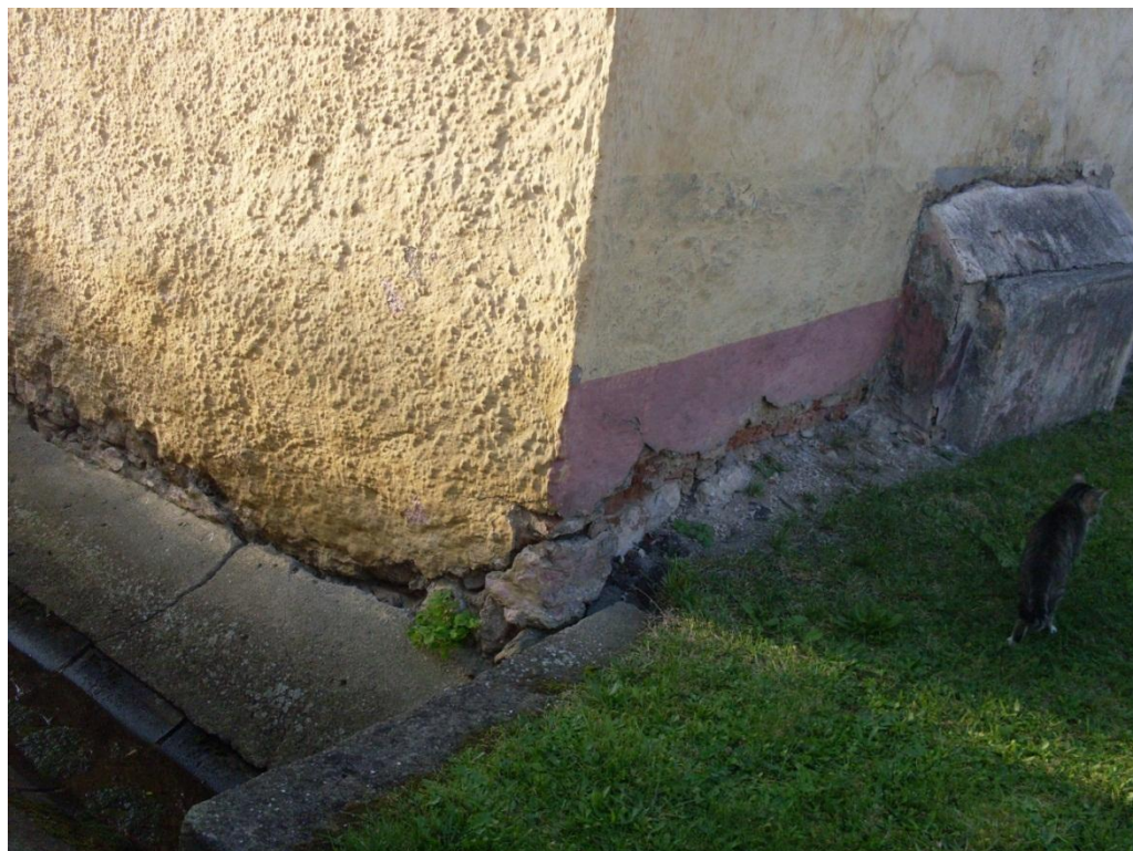
Příloha 23: Rituální lázeň ve Strážově. Odtok vody podél stěny stavení.
