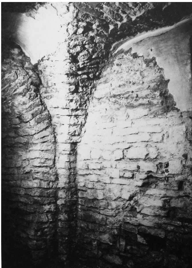
32. Vyšehrad , bazilika sv. Klimenta a Vavřince, poslední třetina 11. století, pohled od západu na závěr severní apsidy s původní klenbou
