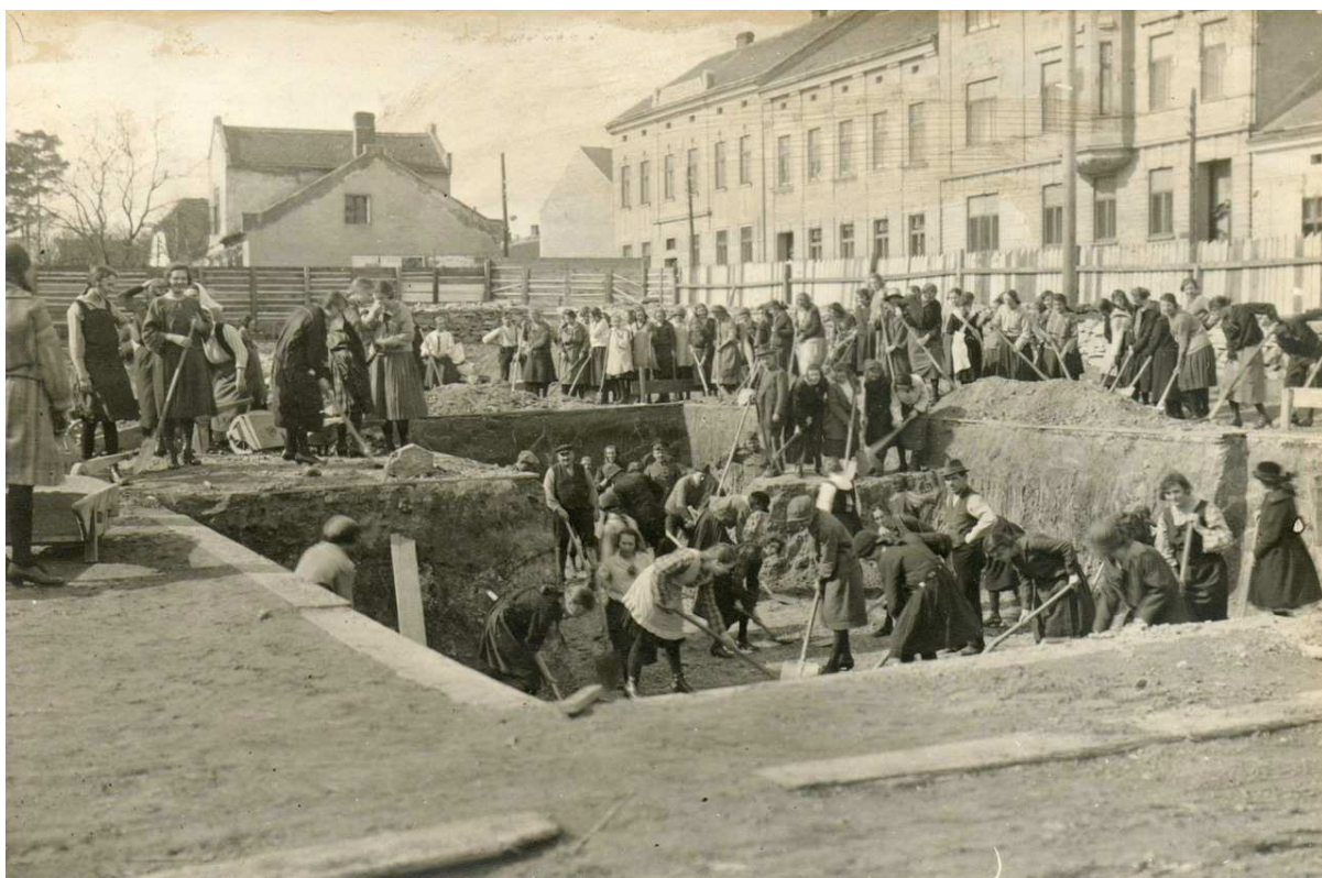
Obr. č. 2: Sokolovna – staveniště 10.4.1924, dělníci pro kopání základů, v pozadí ulice Sokolská. (výkop sklepa, pracovní povinnost, zúčastnily se též žákyně Vlasty, členky Orla jen přihlíží), darováno od Obce sokolské. (F II/ 1097/2)
