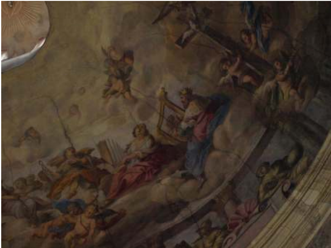
95 Trhliny v klenbě kopule. Foto: Petr Hobza
