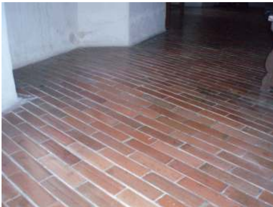
135 Vzdouvající se podlaha v severní chodbě kostela. Foto: autor
