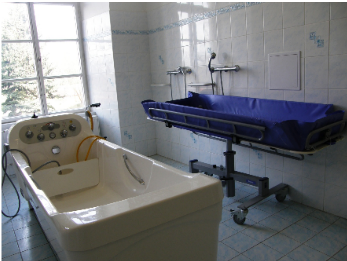
Obr. č. 7 – Část koupelny s hydromasážní vanou a sprchovým lůžkem pro imobilní uživatele
