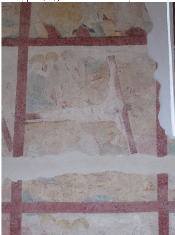
Obr. 20. Přibíjení na kříž, po 1510, severní stěna lodi, kostel sv. Mikuláše, Nepomyšl
