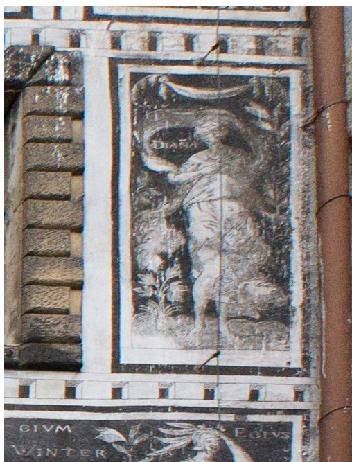
30. Lehce poškozené vyobrazení bohyně Diany na severním křídle zámku.
