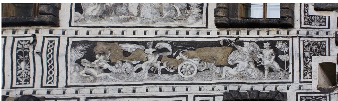
25. Poškozený výjev bojové scény na východní straně severovýchodního bastionu.
