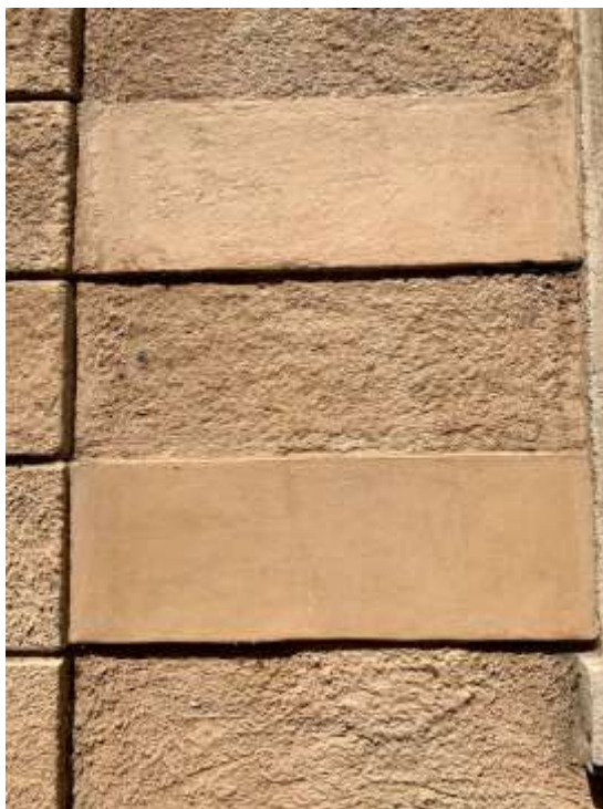
24. Detail fasády Lužického semináře seminář (Praha, 1726-1728, Kilián Ignác Dientzenhofer): ukázka utažených a zdrsňených pásů omítky
