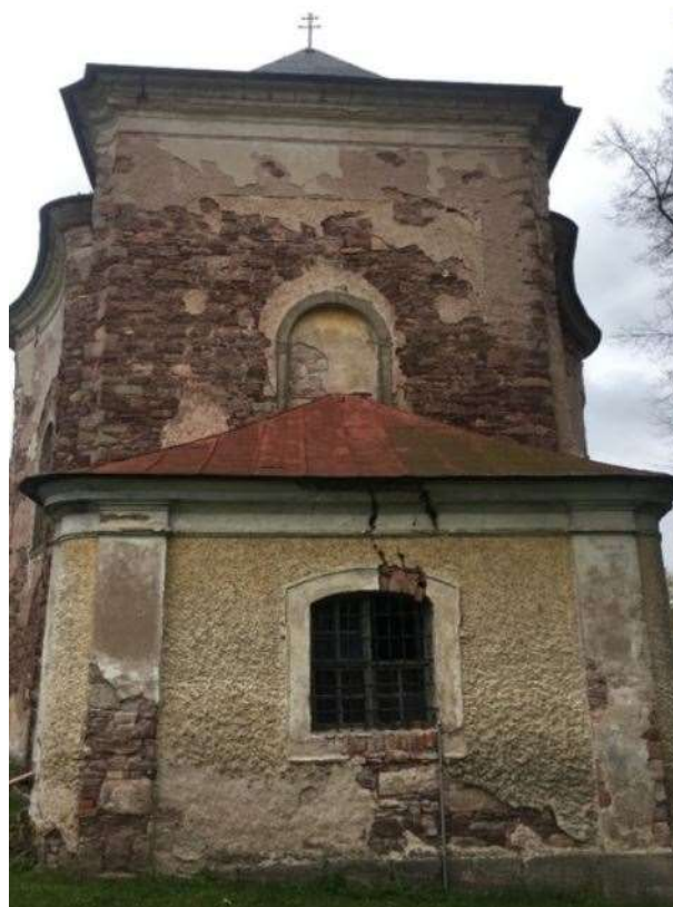
25. Heřmánkovice , kostel Všech svatých, 1722–1726, trhlina ve zdivu sakristie
