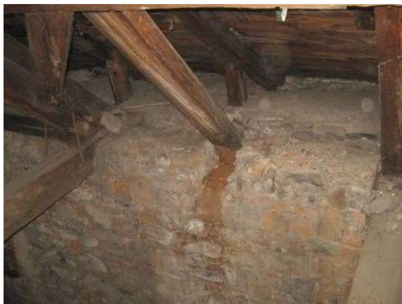
19. Horní Police , kostel Navštívení Panny Marie, 1718–1726, chybějící vazný trám krovu
