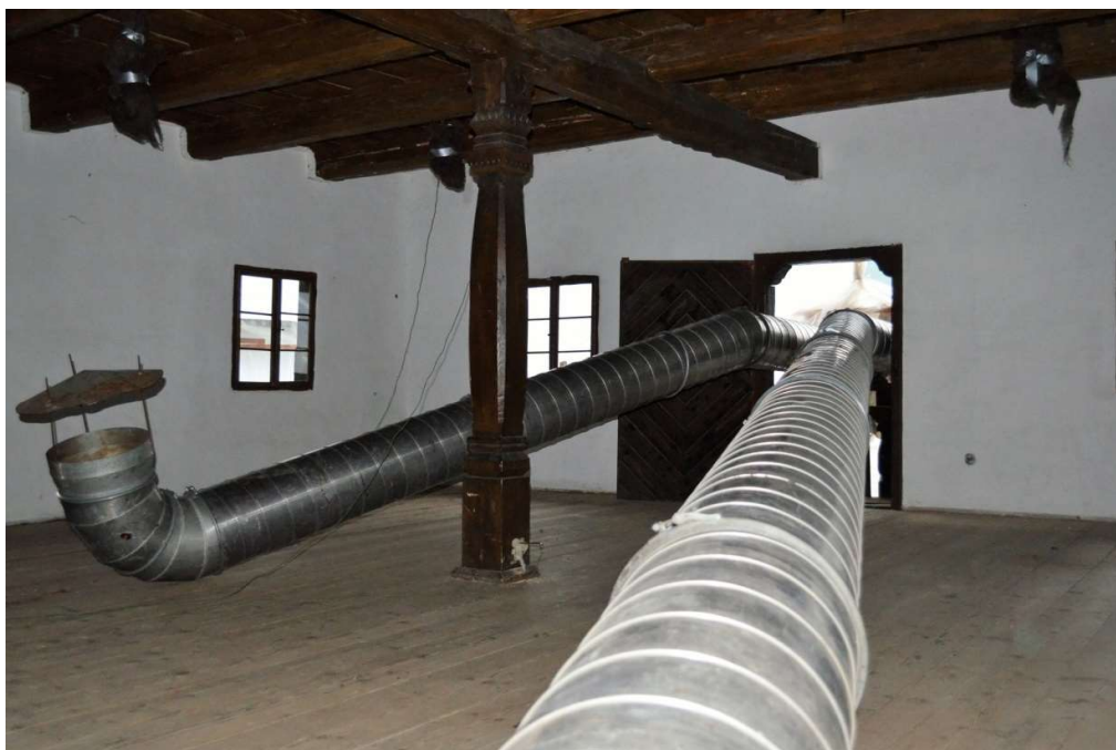
12. Rožnov pod Radhoštěm, radnice, 1770, příklad termosanace, potrubí pro vhánění horkého vzduchu
