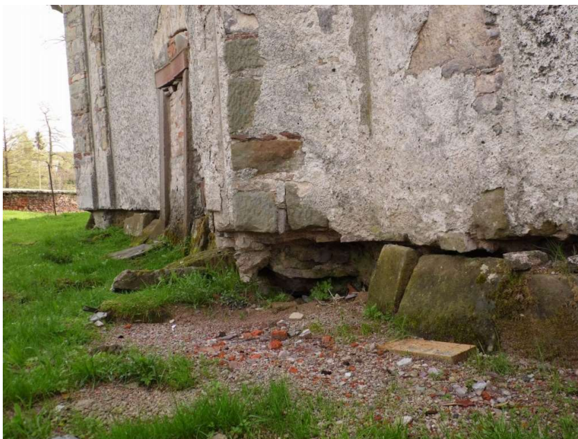
24. Vižňov , kostel sv. Anny, 1724–1728, vyvalené a narušené zdivo soklové partie
