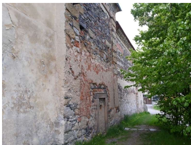
43. Horní Police , ambit, 1719–1724, absence omítek na vnější straně severní stěny
