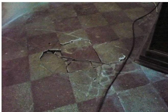
39. Arnoltice , kostel Nanebevzetí Panny Marie, 1756–1758, narušená dlažba lodi kostela vlivem prorůstajících kořenů
