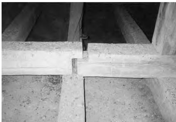
6. Ledčice , kostel sv. Václava, 1738–1745, narušení spoje trámu
