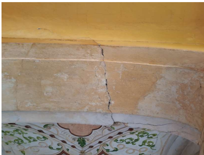
42. Horní Police , ambit, 1719–1724, trhlina na klenebním pasu v jižní chodbě
