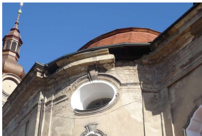
26. Děčín , kostel sv. Václava v Rozbělesích, 1731–1783, jihovýchodní nároží, detail chybějících úseků hlavní římsy
