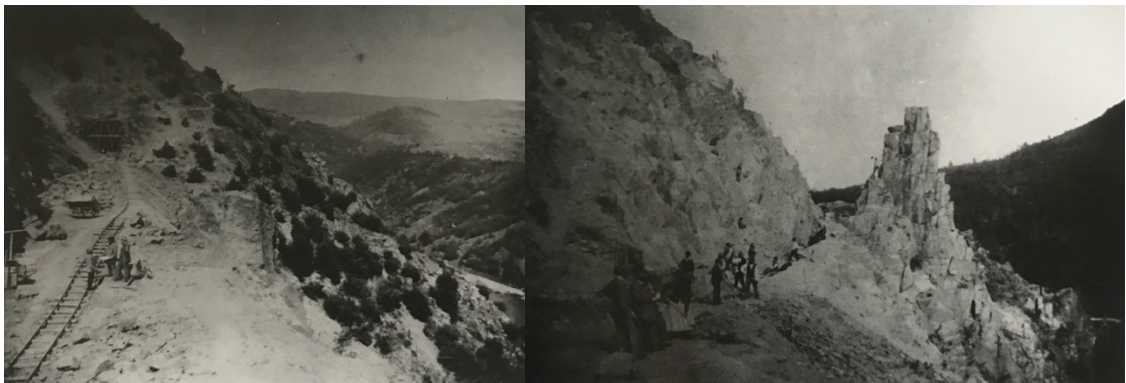
Vlevo: Scéna připomíná scénku zlatokopů z divokého západu, ve skutečnosti snímek dokumentuje stvbu železničního tunelu mezi zastávkou Luka pod Medníkem a Jílové u Prahy, 1898-99. Vpravo: Příprava posázavské železnice u Pikovického komína, 1998-99. Zdroj: KUCROVÁ, 2013.
