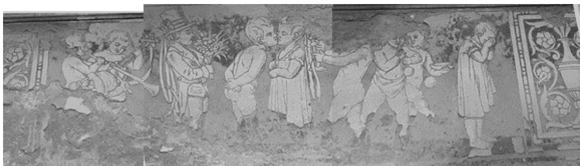
7 Viktor Schubert, sgrafitová výzdoba na fasádě, Jaro, 1871, NPÚ, Fotografie stavu sgrafitové výzdoby na fasádě v roce 1991, inv. č. 14/10
