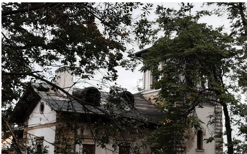
13 Zdenko Schubert von Soldern, Schubertova vila, pohled na západní stranu, současný stav.
