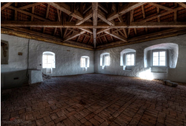
60. Vlčkova věž na třetím nádvoří, Horní zámek, interiér druhého patra s průhledem do krovu.
