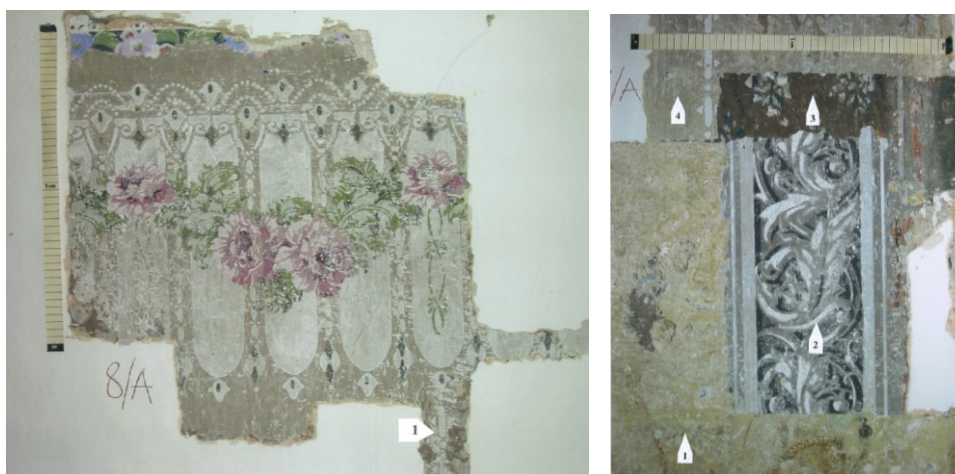
84. Místnost A , secesní malba z přelomu 19. a 20. století, prostory velkého sálu, jižní křídlo Dolního zámku. Šablonová malba architektury s květinovými girlandy v horní části zdi. 1 – perlovec, který vertikálním směrem v pravidelných rozestupech člení plochu zdi.
