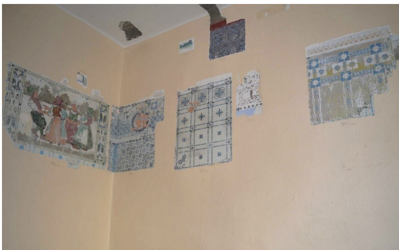
39. Příčné (kolovratské) křídlo Horního zámku, interiér, restaurátorské sondy odhalující části výmaleb 19. a 20. století.
