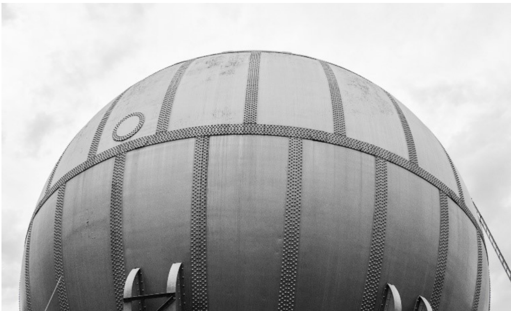
6. Záplata, kterou plynojem nese od poškození tříštivým granátem.
